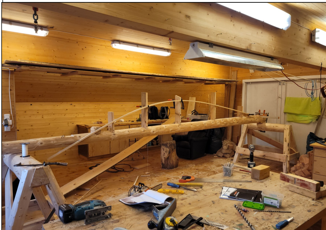
Fig. 2. Bukkene ble bygget av grove materialer og med rester av grana som ble felt til byggestokk. Prambordets fasong skulle kopieres fra oppmålingen av Lårdalsprammen. Ved hvert av målepunktene ble det satt opp midlertidige avstandsstykker. Fasongen ble prøvd ut med ei rei.
