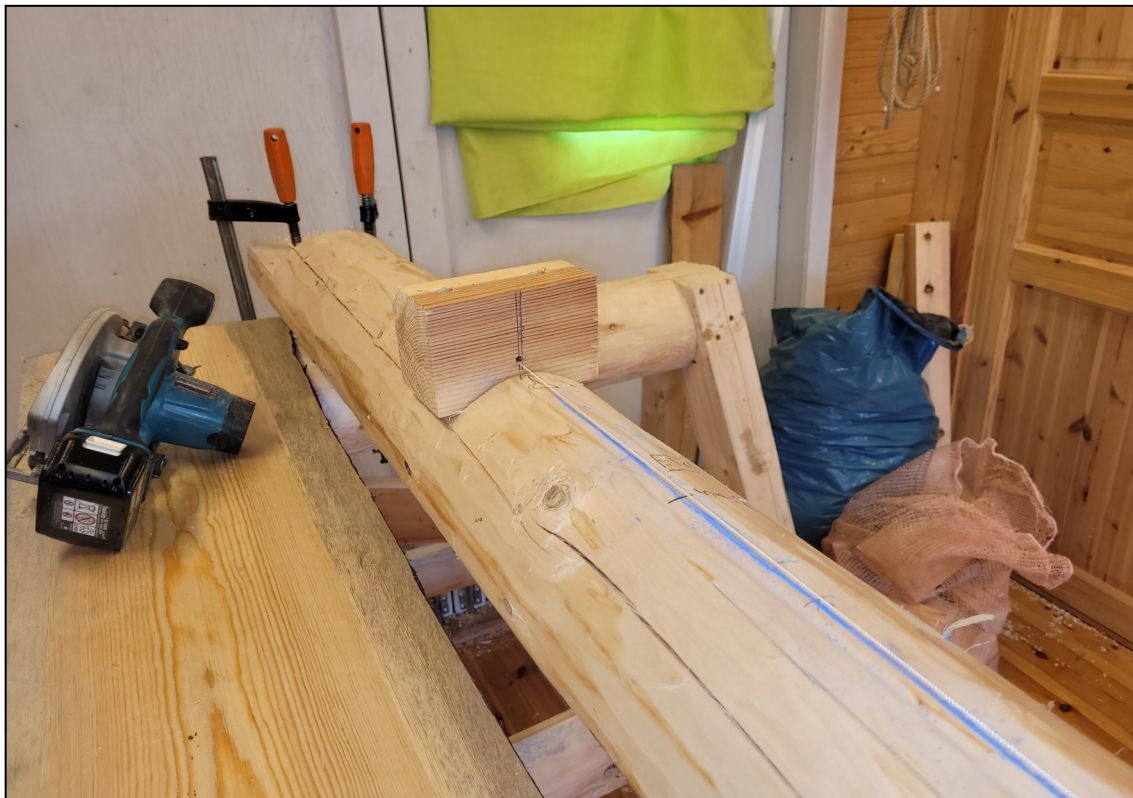
Fig. 3. For bruk til egen kontroll under byggingen strekkes det en snor under byggestokken (stokken ligger opp/ned på bildet). Snoren gjenskapte et punkt som ble etablert under oppmålingen av Lårdalsprammen. Snoren tilsvarer en innfesting 5 cm opp på fram- og akterspeil på den oppmålte Lårdalsprammen. Den viktigste funksjonen var å gi målepunkt for prambordets bue og form.
