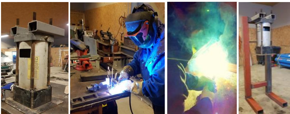
Figur 54: Viser innramming av luftsylander for feste i stativ og ekspanderende del nederst. Figur 55: Viser meg tigsveise på en jekke-trapp for vektstangprinsippet. Figur 56: Viser Stig Tore Rønning, fra Mobilt Industriverksted, som sveiser beinkonstruksjonen. Figur 57: Viser ferdig montert luftsylander på ramme
