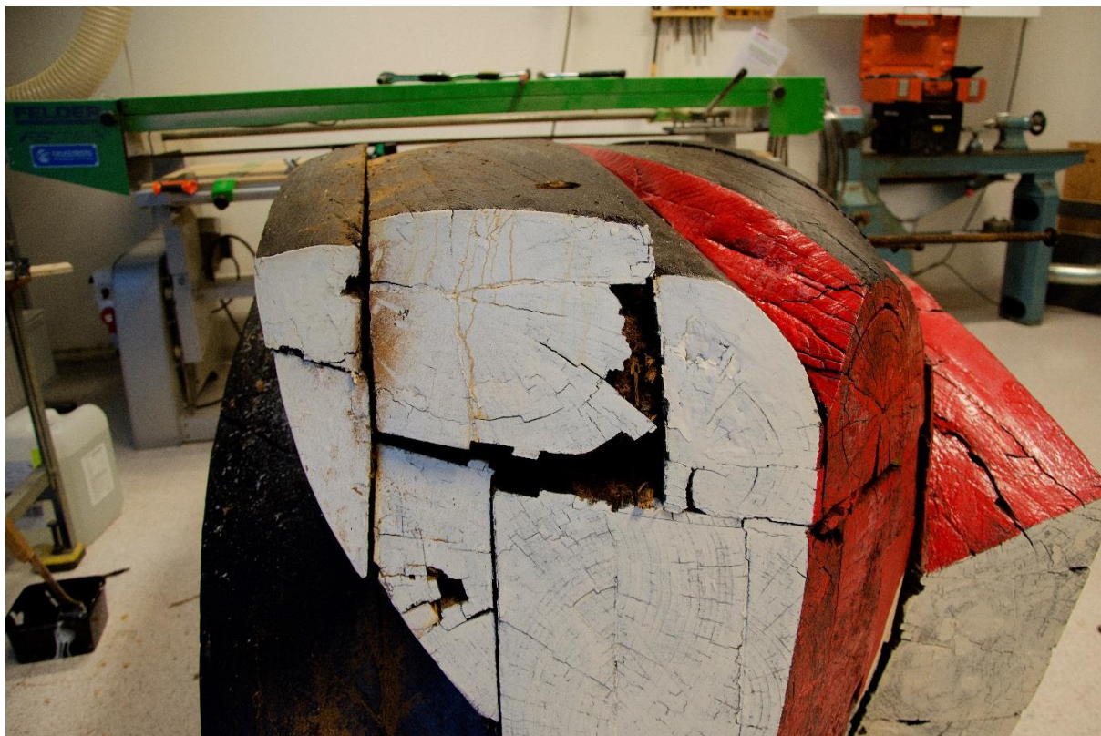
Illustrasjon 1: Utgangspunktet – trevirke som er så råttent at trefibrene ikke lenger holder sammen, og store sprekkdannelser i konstruksjonene.
