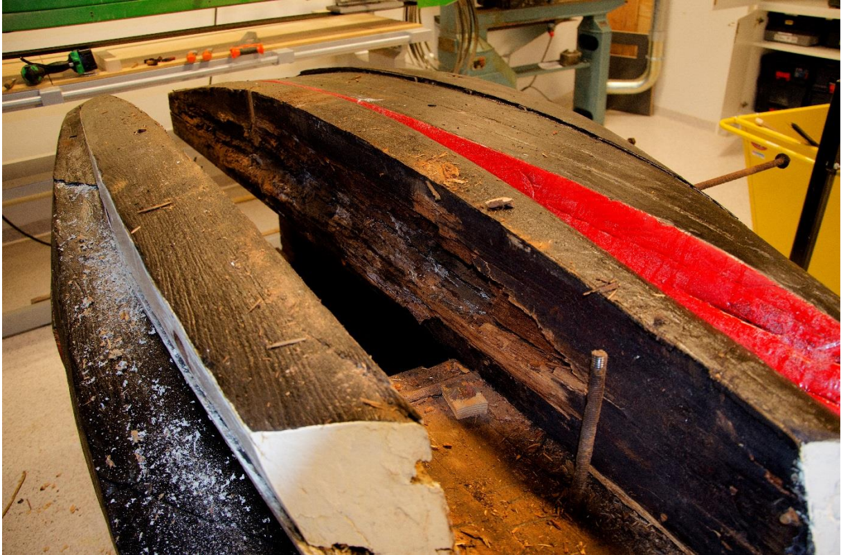
Illustrasjon 4: Bildet viser hvordan «Tønsberg Tønne» er konstruert, i og med at jeg har fjernet en del. Vi ser også at det betydelige råteskader i emnet som har ligget inntil det som er tatt ut. Også dette emnet er så skadet at det må erstattes.
