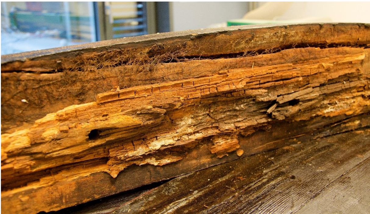
Illustrasjon 3: Her er en av kubbene demontert, og vi kan tydelig se hardt soppangrepet trevirke med svært omfattende råteskader.
