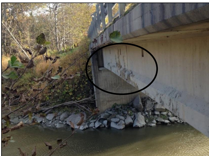
Figur 6-9 Under brua samlet det seg skredmasser, og her ser man rester av skredmassene (se sirkel) på undersiden av brua hvor veien krysser Reina (foto B. Gundersen 2014).
