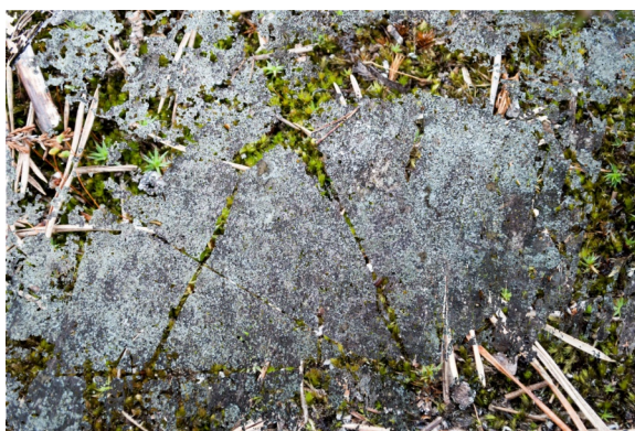
Figur 9: Mose invaderer berg i formen til rustinvasjon av jern
