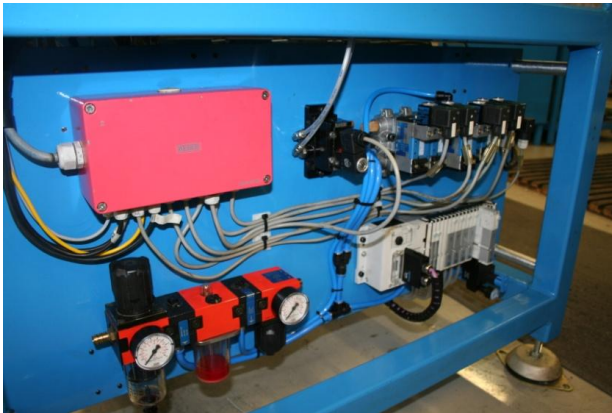
Figur 72 Luftbehandlingssystem montert og koblet opp nederst til venstre.
