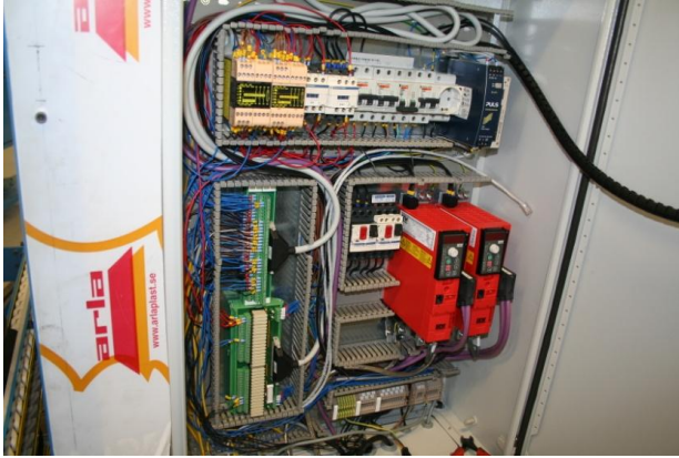
Figur 82 El. skap ferdig koblet.
