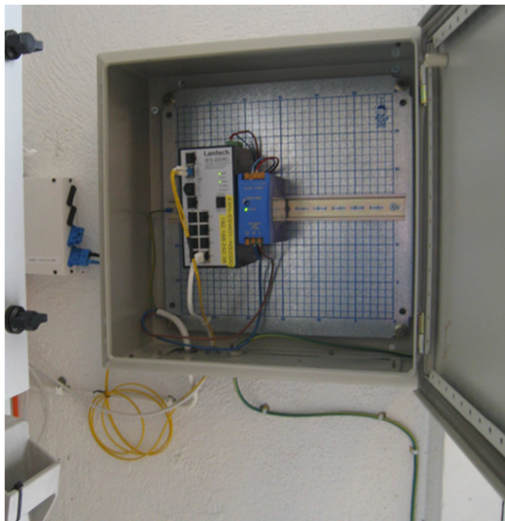
Bilde 6 Ferdig koblet skap
