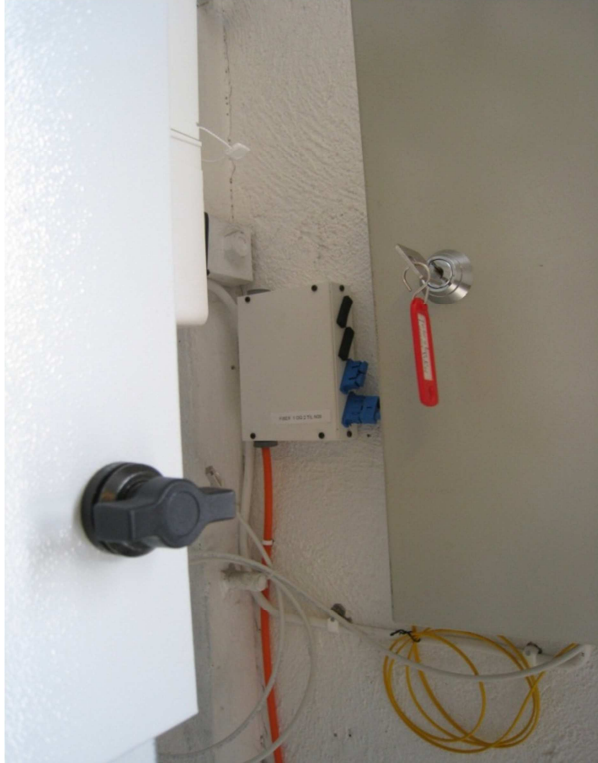
Bilde 8 Terminert fiber og montert skap i Nettstasjonen
