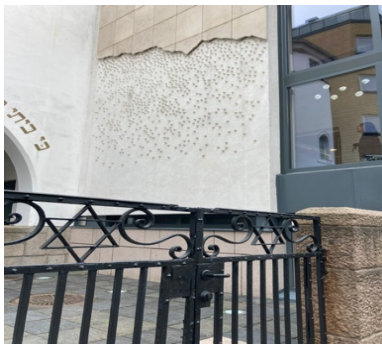
Bilde 4: Høyre yttervegg. Foto: S. Myklebust
