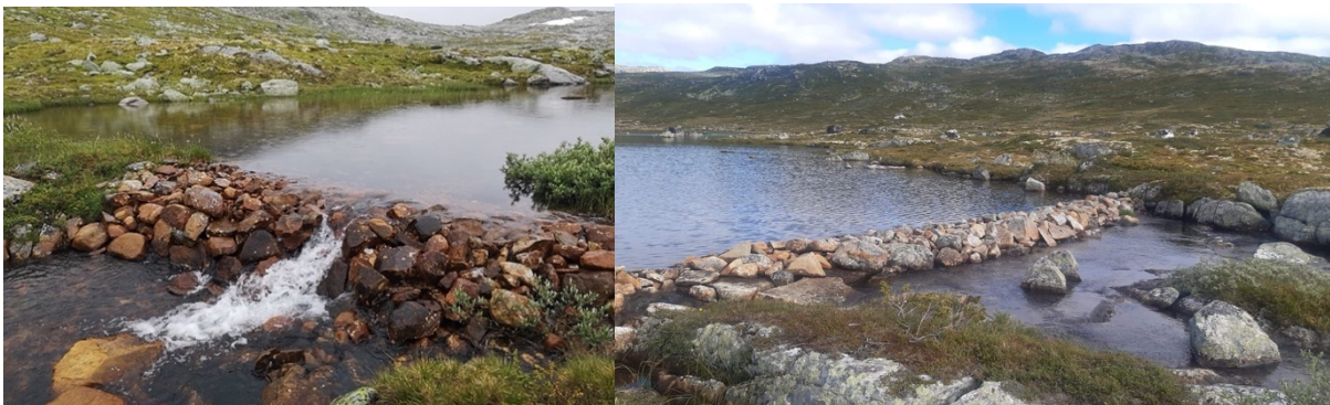
Figur 3: Til venstre: demning i utløpet fra det øvre av de to sammenhengende vannene i Svartevassdalen. Til høyre: demning i utløp fra det nedre vannet i Svartevassdalen. Foto: t.v. Ola Flæte Kristensen, t.h. Peter Groth Farsund
