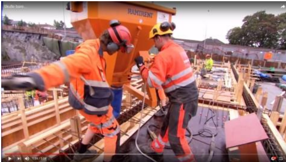
Bilde 22 Et eksempel på byggeplassaktivitet hvor lyden samtidig passer til det vi ser.
