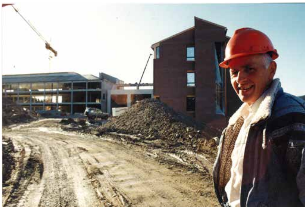
Reidar Førde framfor oppføringa av det nye høgskulebygget. Førde hadde hovudansvaret for bygge- og anleggssektoren ved høgskulen. (Foto: utlånt av Førde)
