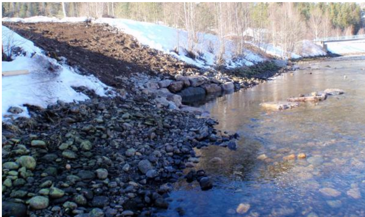
Figur 2.6. Etablering av kile med grovsteinede buner på elektrofiskestasjon 5 i Vallaråi. Selve kilen er bygd av grove steiner, og bunene utenfor styrer vannstrømmene inn i kilen (Kildal 2012; Kildal 2013).
