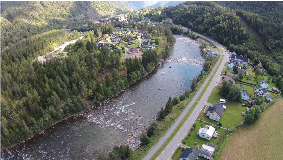
Figur 2. Gravearbeider nedstrøms Geishyl med utlegging av stor blokk (øverst) og ombygde terskel 1 og 2 med et utjevnet brekk/fall og mer strykhabitat (nederst). Foto: Statkraft.
