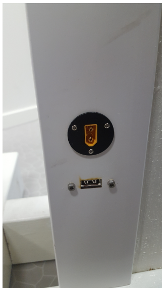
Figur 5.68: Tilkoblingspunkt for nødstop-panelet.
