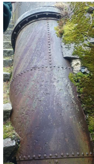
Figur 32. Detaljer fra gammelt rør ved Tinfos-fabrikken i Notodden. Bilde: Audun Stikbakke.
