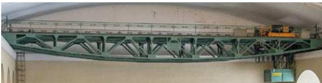
Figur 17. Kran- travers i stål fra Såheim Kraftstasjon. Foto: Per Berntsen (Taugbøl et al., 2014).
