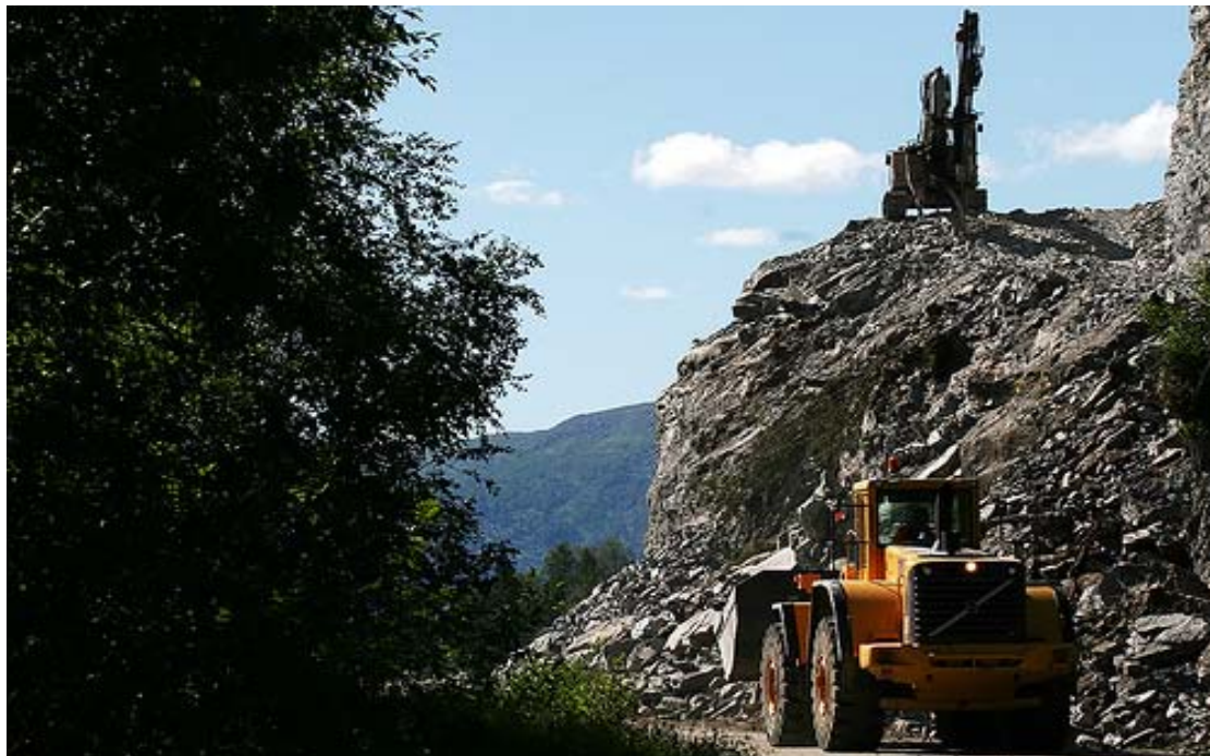
Foto: Det må arbeidast langs mange dimensjonar i utviklinga av Rv 13Fjordvegen, både funksjonelt, med opplevingar og med skreddarsaum.
