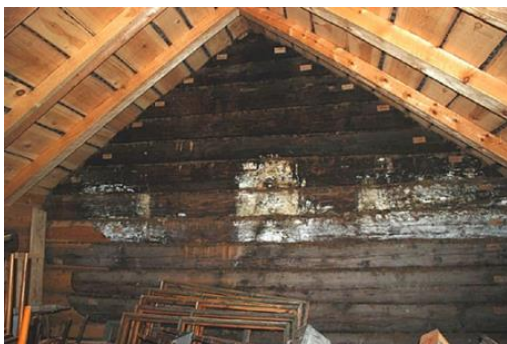
Figur 32 Spor av kroting på nordveggen i 2010, foto: Johild Mæland
