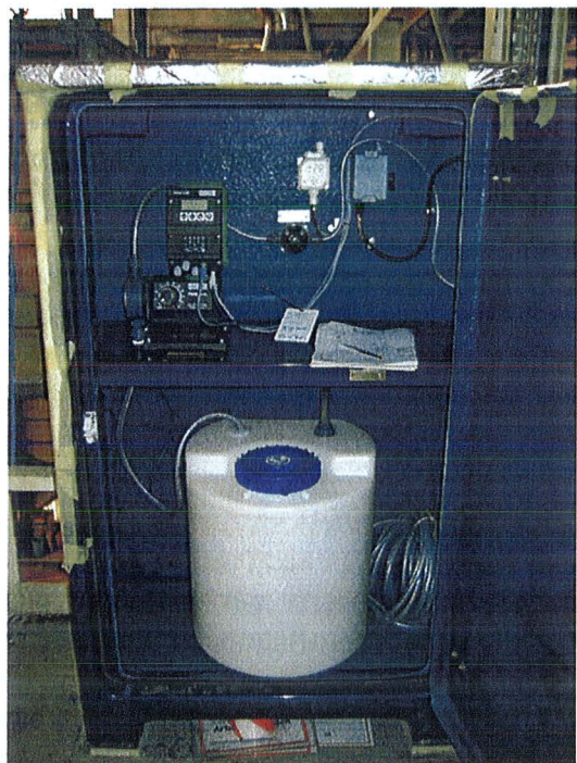
Figur 8.3: Mengdestyrt kloreringsanlegg, trygt plassert i et skap (Foto: Bjørn Løfsgaard)
