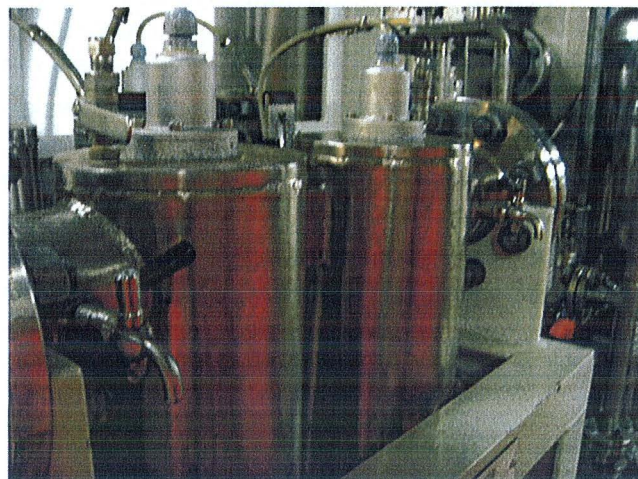
Figur 8.5: UV-anlegg med kraner som muliggjør vannprøver før og etter desinfeksjon (Foto: Eyvind Andersen)
