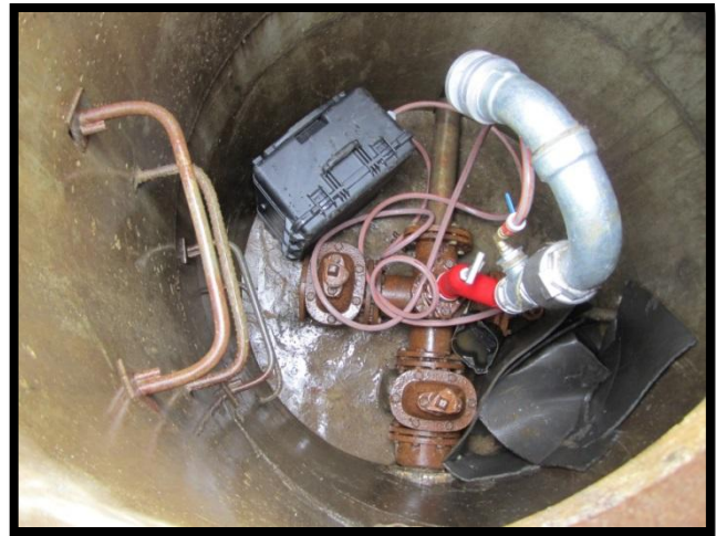
Bilde 6: RPM enhet ved kontinuerlig loggføring i brannkum
