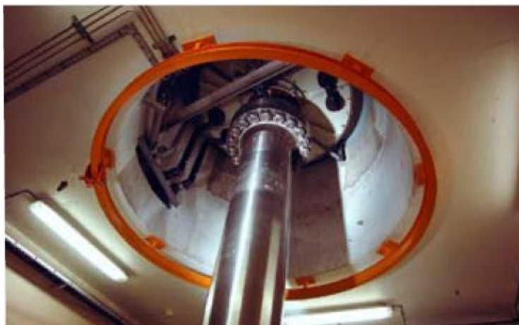
Figur 5 Nygard kraftverk – turbinaksel og generator
