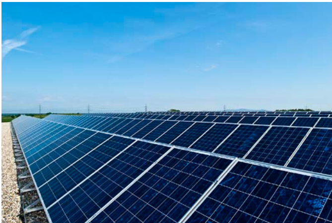
Fig 1.1 Solcellemodulinstallasjon i tyskland.
